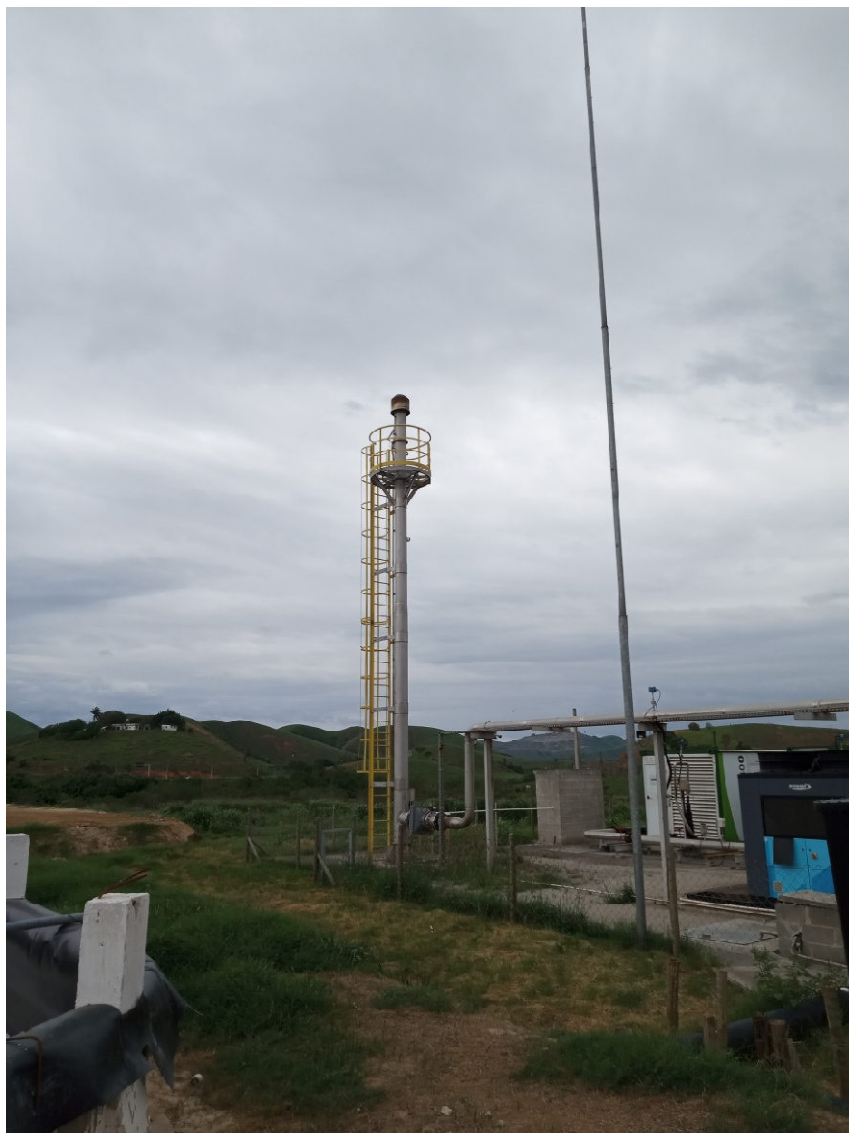
Figura 27: Flare da Estação de Biogás
