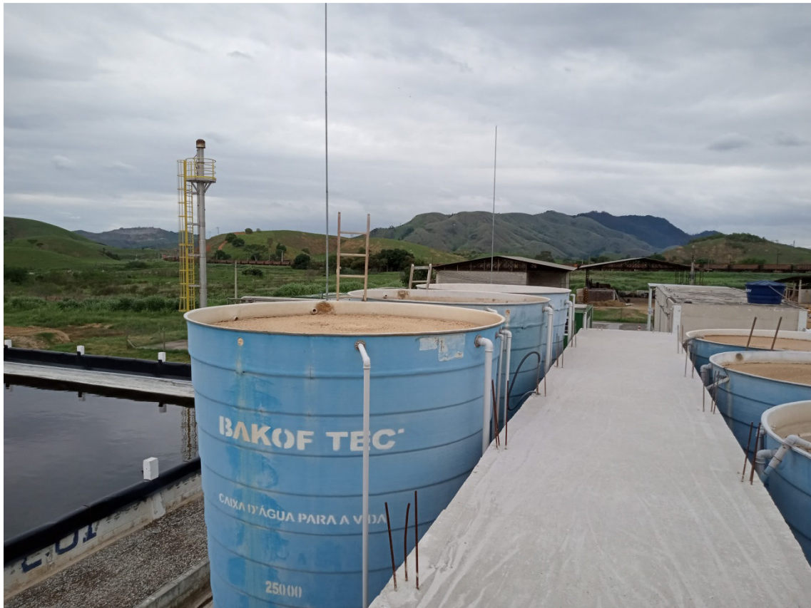
Figura 18 : Tanques da estação de tratamento de chorume
