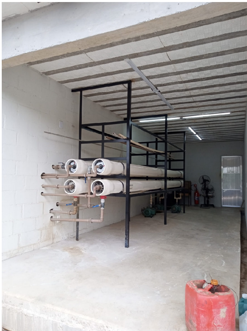
Figura 16: Equipamento de osmose reversa em operação.
