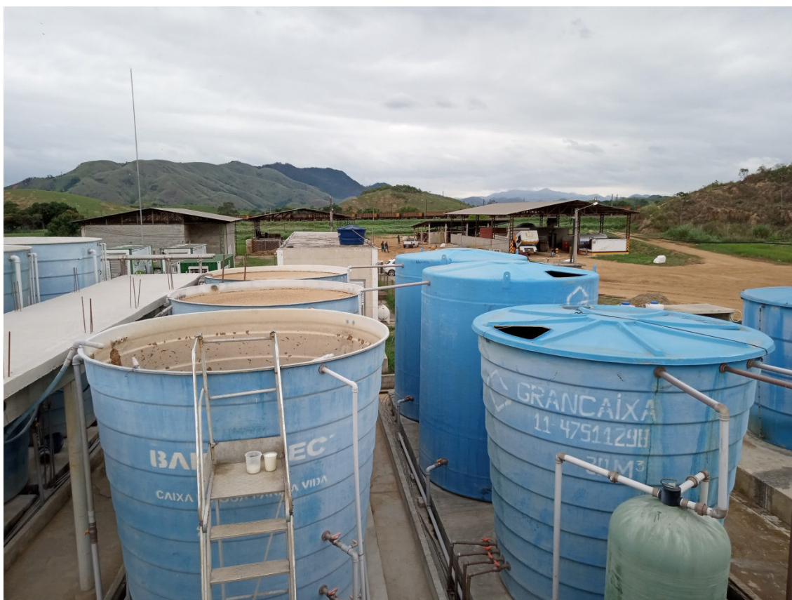
Figura 17: Tanques da estação de tratamento de chorume
