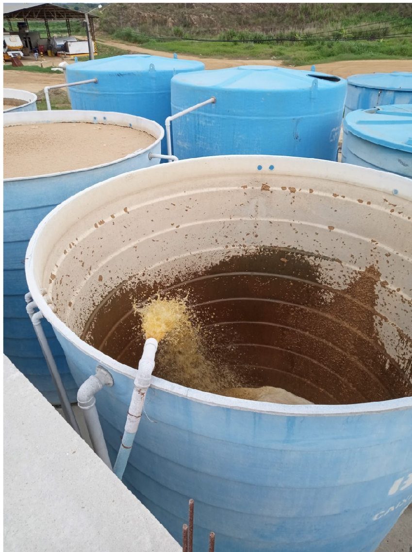
Figura 19 : Tanques da estação de tratamento de chorume
