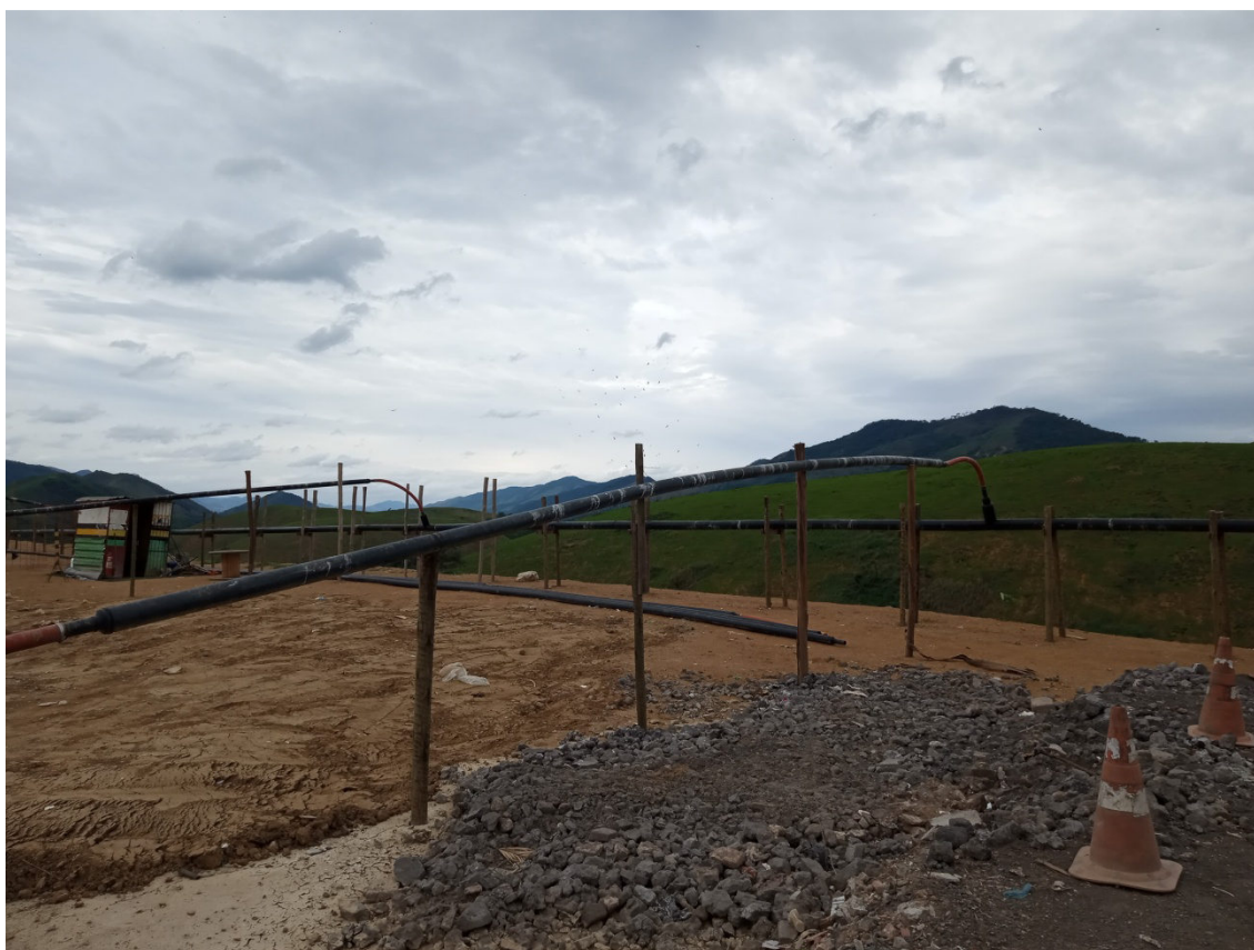
Figura 8: Dutos de captação do gás
