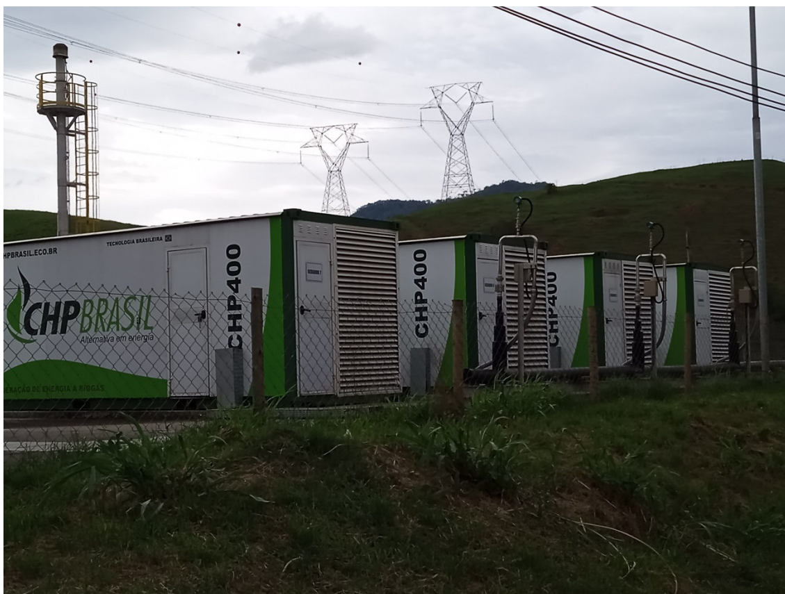
Figura 26: Grupo de geradores da Estação de biogás
