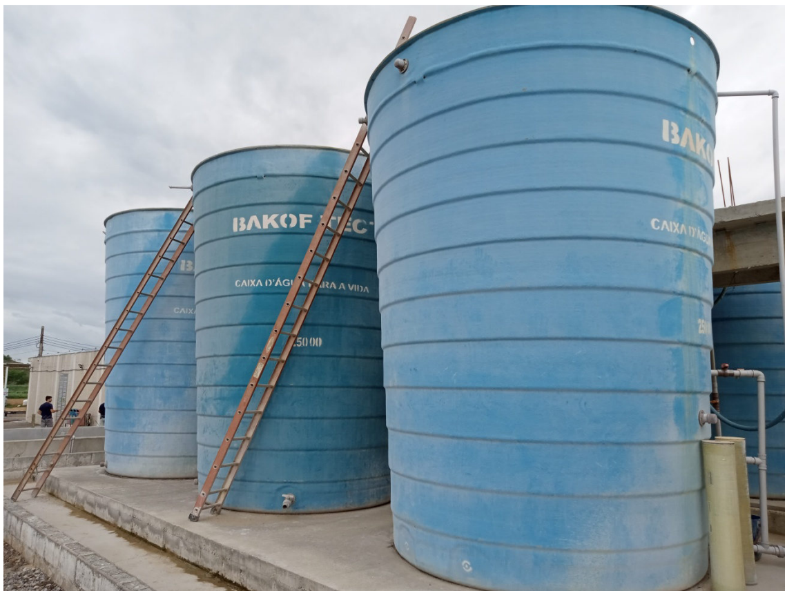
Figura 20 : Tanques da estação de tratamento de chorume
