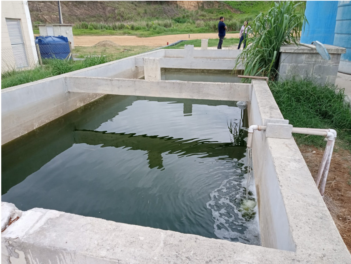
Figura 21 : Tanque de recebimento de água de reuso após tratamento
