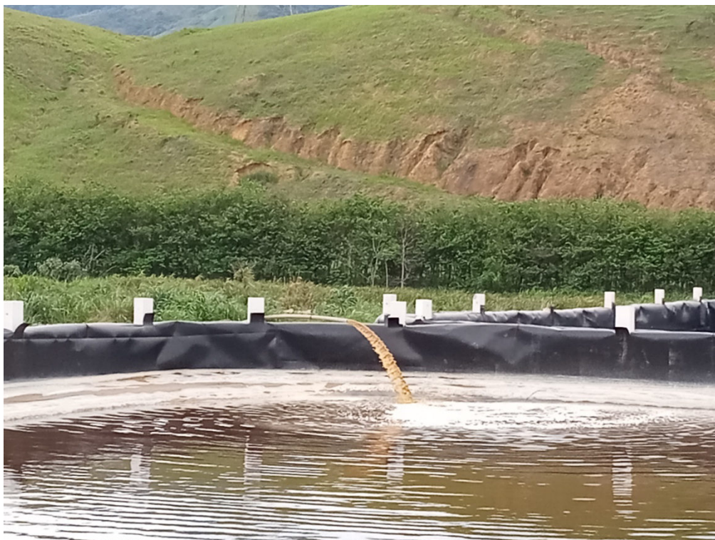
Figura12: Lagoa de recebimento de chorume
