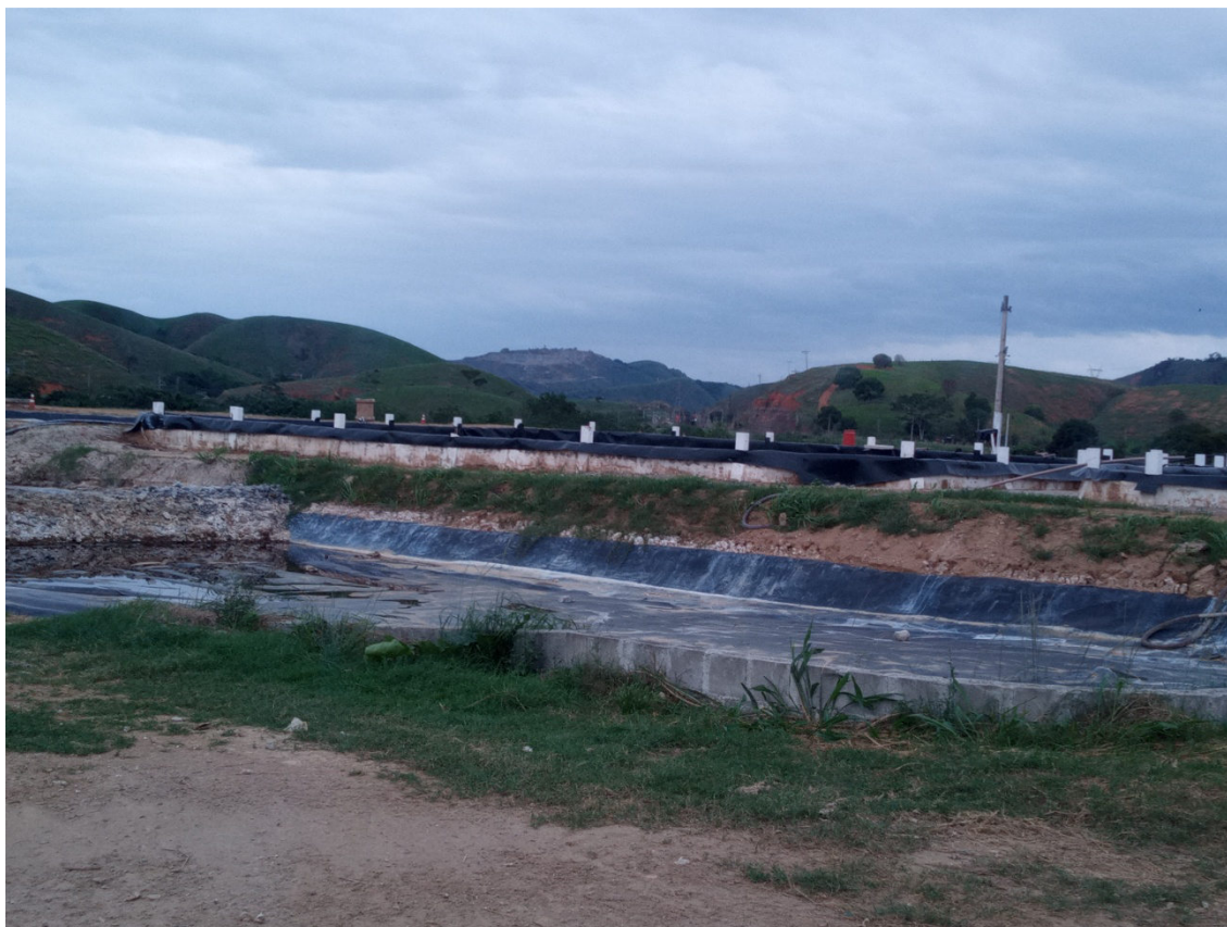
Figura15: Leito de secagem do lodo
