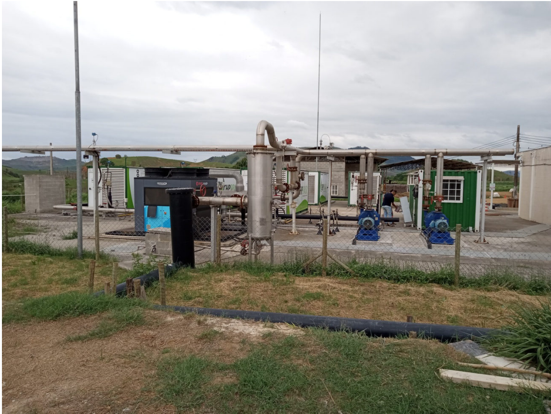
Figura 25: Estação de biogás
